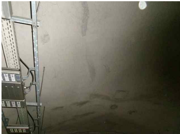
라이닝 S07 천단부 균열(Cw=0.3mm이상)-문산방향
