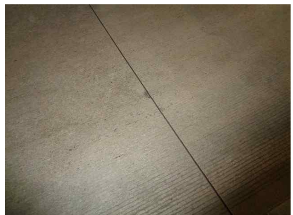
포장부 S39 포장부 파손-문산방향
