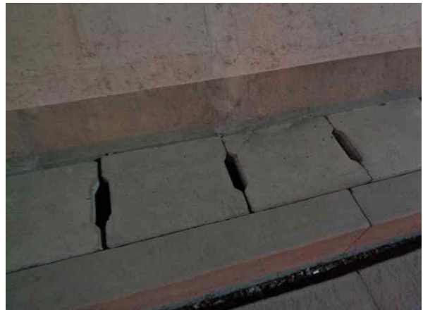
공동구 S39 뒹개 파손-서울방향
