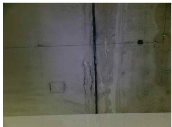
라이닝 S46 측벽부 균열부 백태-문산방향
