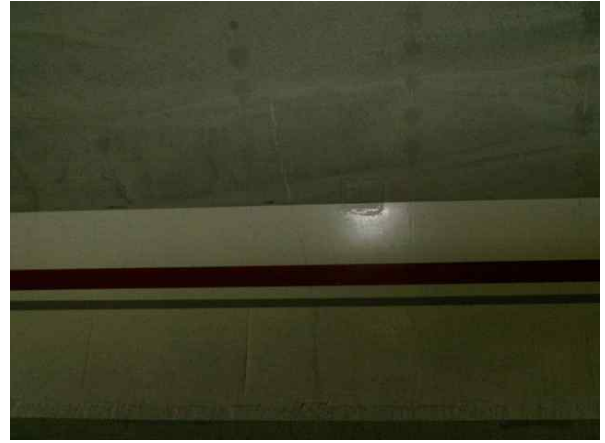
라이닝 S29 측벽부 균열( C_w=0.3\text{mm} 이상)-서울방향
