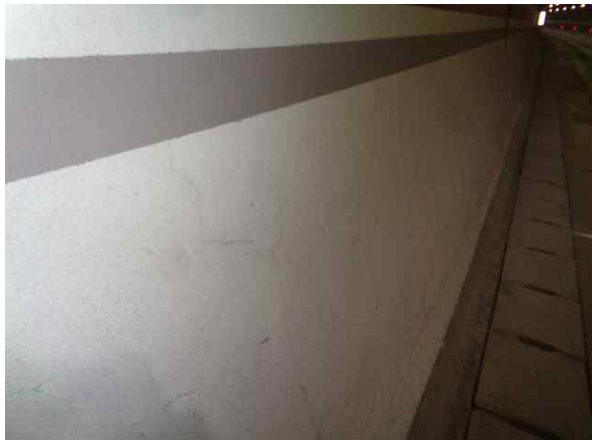
라이닝 S21 측벽부 망상균열-서울방향
