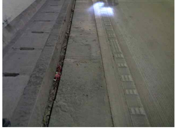
포장부 S39 갓길측 파손-문산방향
