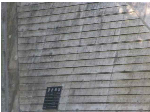
중점측 갭문 균열( C_w=0.3\text{mm} 이상)-서울방향
