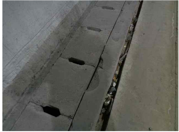
공동구 S21 파손-서울방향
