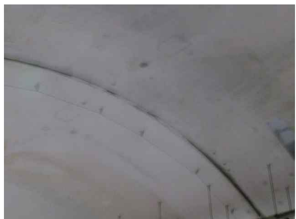
라이닝 S02 천단부 폐콘크리트 미제거-서울방향
