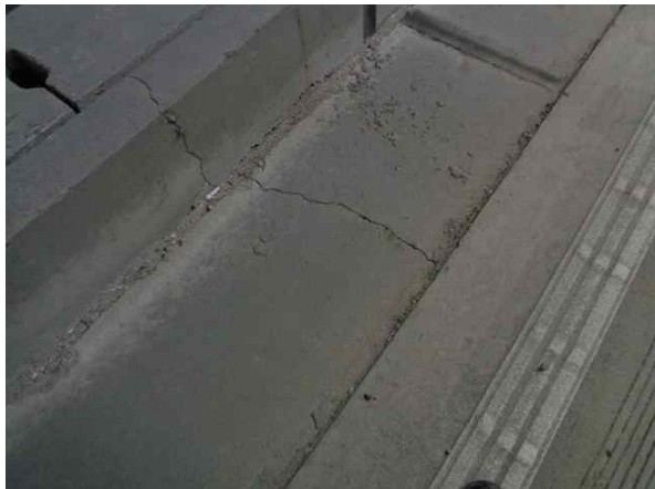
포장부 S01 균열-서울방향
