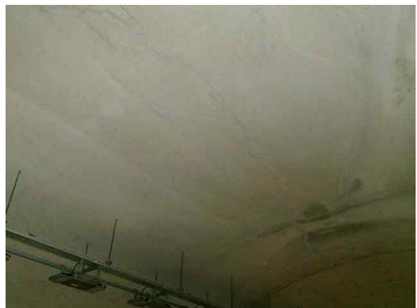
라이닝 S26 천단부 재균열(Cw=0.3mm이상)-서울방향
