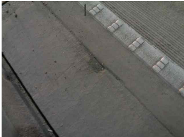
포장부 S15 파손-문산방향
