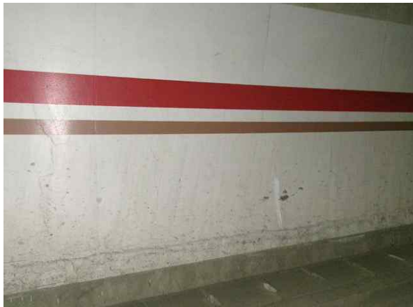
라이닝 S32 측벽부 망상균열-서울방향
