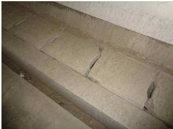
공동구 S12 덮개파손-문산방향
