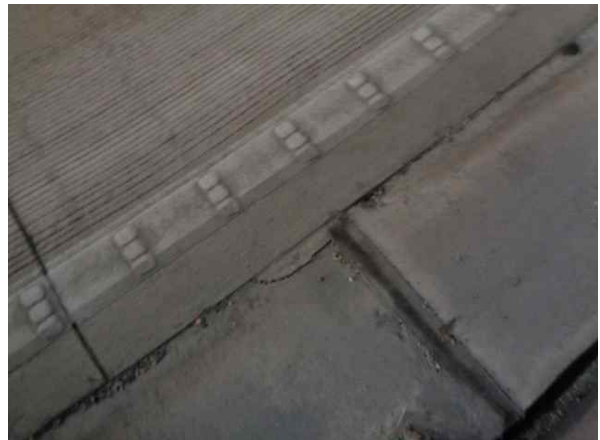
포장부 S32 파손-문산방향
