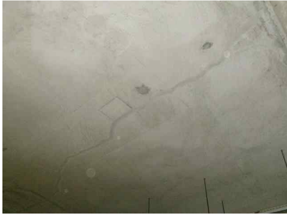
라이닝 S05 천단부 재균열 ( C_w=0.3\text{mm} 이상)-문산방향
