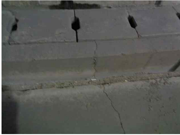
공동구 S20 균열( Cw=0.3\text{mm} 이상)-서울방향
