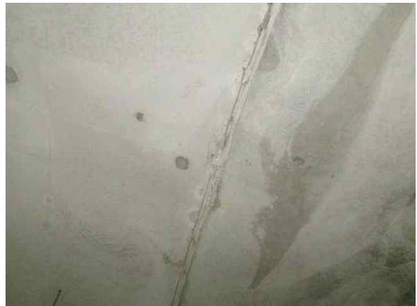
라이닝 S15 천단부 조인트부 들뜸-문산방향
