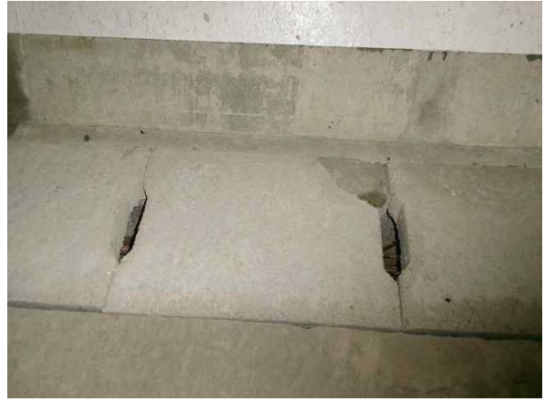
공동구 S44 뒹개파손-서울방향
