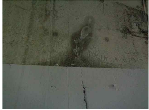
라이닝 S29 측벽부 균열( Cw=0.3\text{mm} 이상)-서울방향
