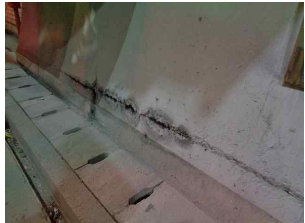
라이닝 S36 측벽부 하단 누수흔적-문산방향
