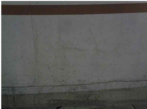
라이닝 S28 측벽부 망상균열-문산방향
