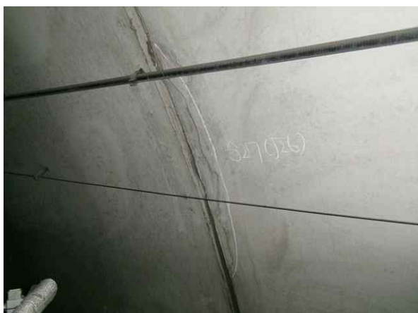
라이닝 S26 천단부 콘크리트 들뜸-서울방향
