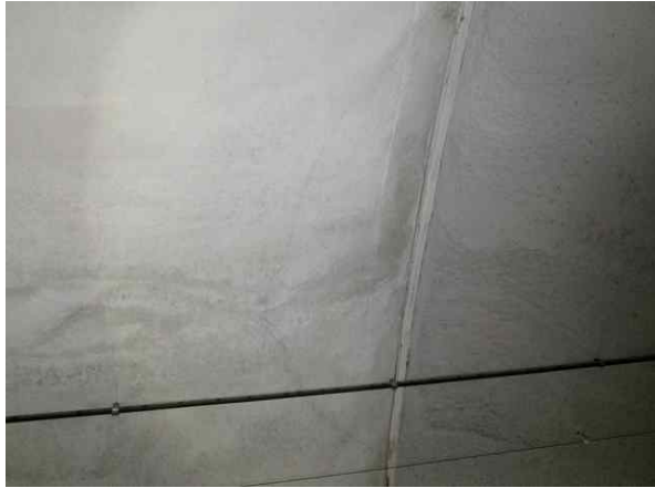
라이닝 S23 천단부 균열(Cw=0.3mm미만)-서울방향
