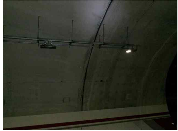
라이닝 S28 천단부 실링재 미시공-문산방향
