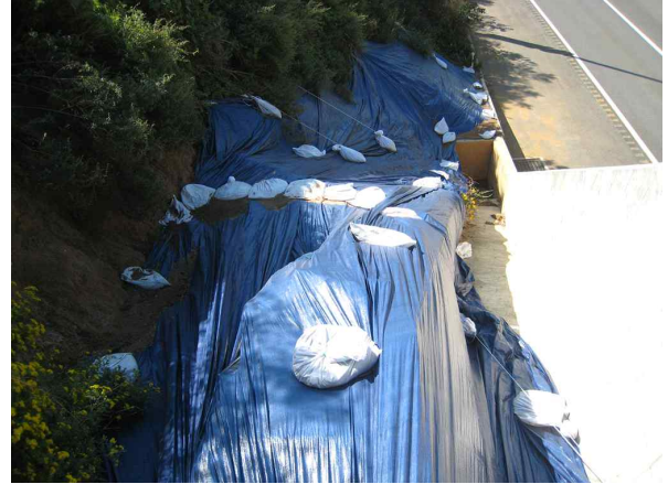
시점측 갭문 측면 토사유실 임시보수-문산방향
