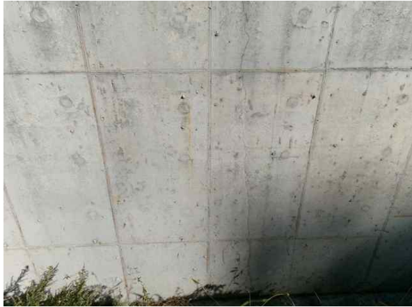
중점측 갭문 균열( Cw=0.3\text{mm} 미만)-서울방향
