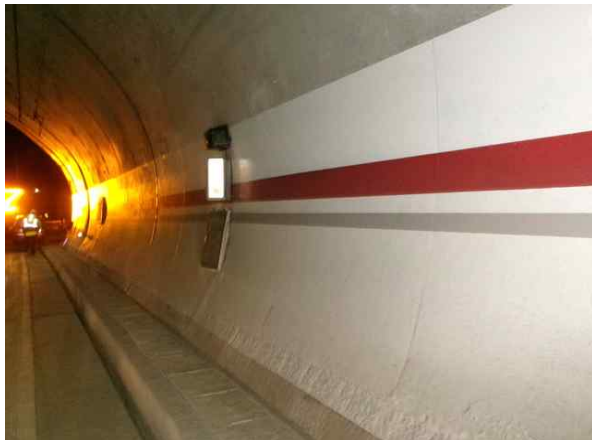
라이닝 S40~42 측벽부 망상균열-문산방향
