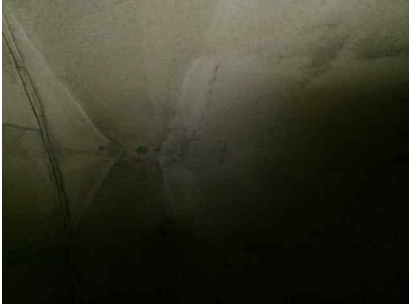
라이닝 S17 천단부 균열(Cw=0.3mm미만)-서울방향
