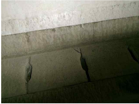
공동구 S20 뒹개파손-서울방향
