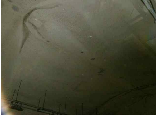
라이닝 S09 천단부 균열( Cw=0.3\text{mm} 이상)-서울방향
