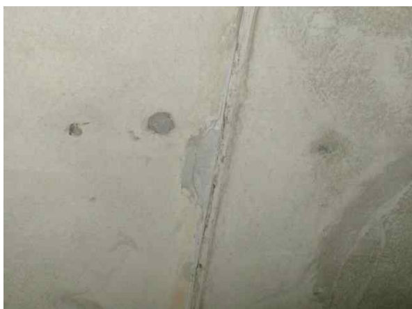
라이닝 S18 천단부 조인트부 재들뜸-문산방향
