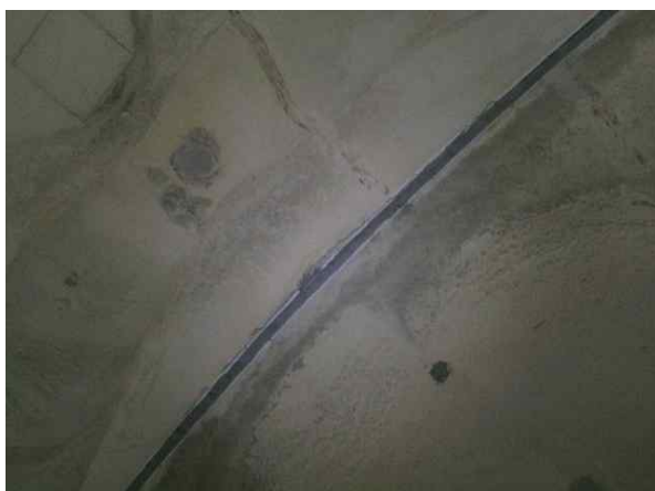
라이닝 S30 천단부 조인트부 들뜸-서울방향
