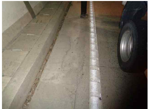
포장부 S35 갓길측 파손-서울방향
