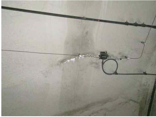
라이닝 S03 천단부 백태-문산방향
