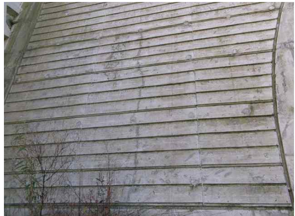
종점측 갭문 균열(Cw=0.3mm미만)-문산방향
