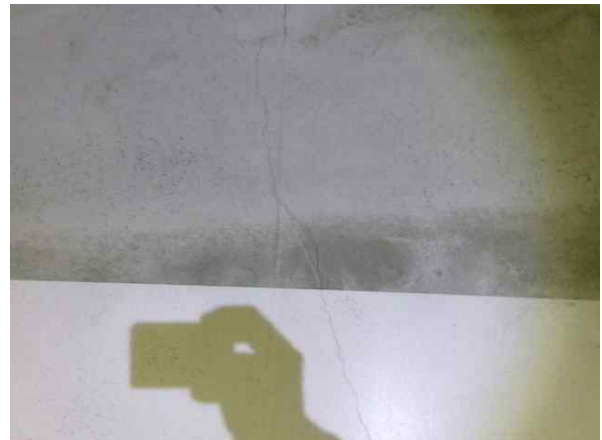
라이닝 S16 측벽부 균열( Cw=0.3mm 이상)-문산방향
